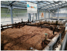
排水処理槽（曝気）
